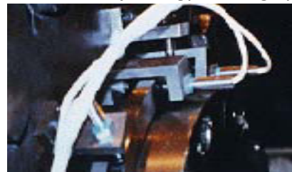
Kettős érzékelő installáció a támcsapágy felügyeletére
